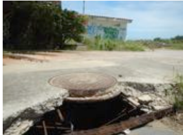
Estación Bombeo Casas del Sol (Playa Real)
