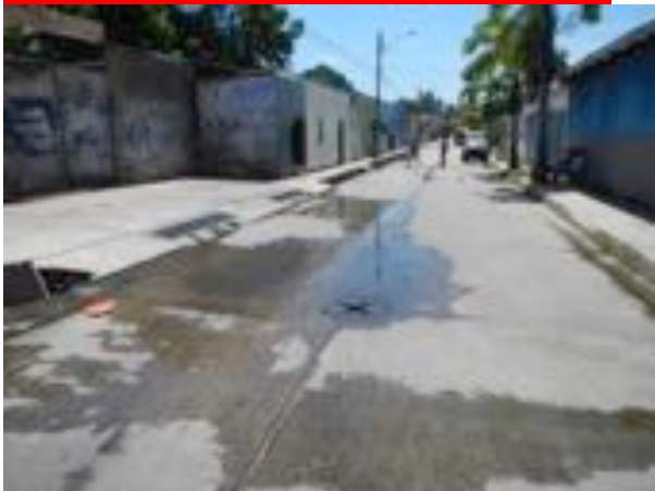
CLOACA REBOSANDO EN CALLE LA MARINA
